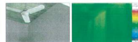
2階リビング天井の内部熱画像です。内層熱画像です。特に温度差は確認されませんでした。
